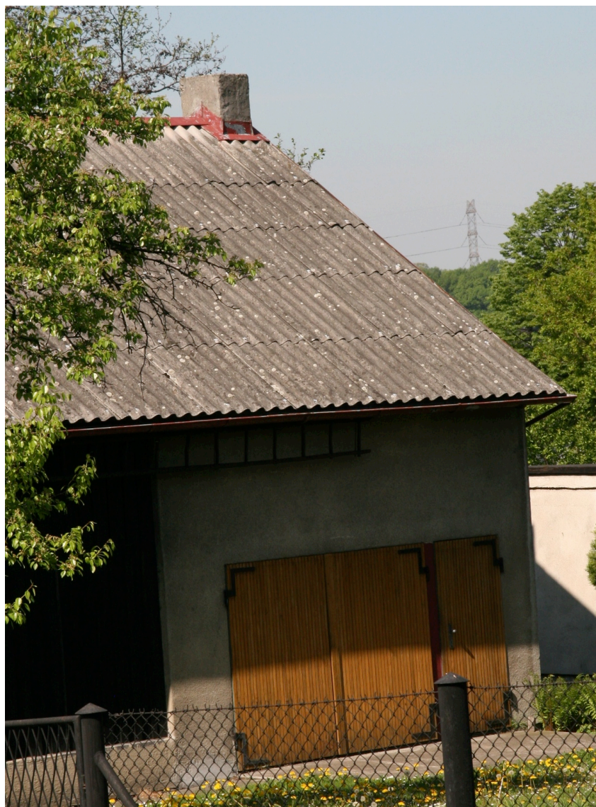
Rysunek 4 Dach pokryty płytami azbestowymi falistymi
